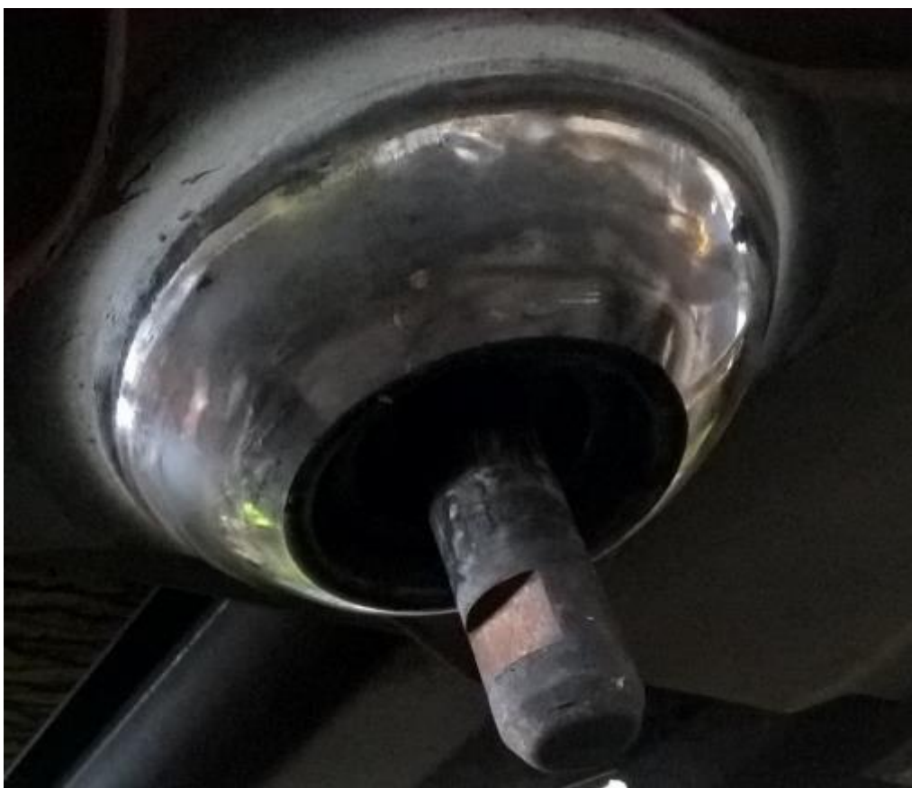
Figuur 15: onregelmatige slijtage aan de oplegbol van de bovenbouw [bron: foto ProRail]
