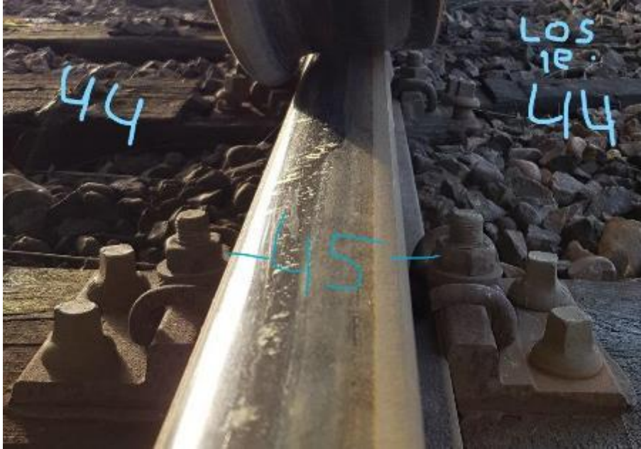
Figuur 19: dwarsligger 45 is vast bevestigd. De daaropvolgende dwarsliggers zitten los of vertonen gebreken
