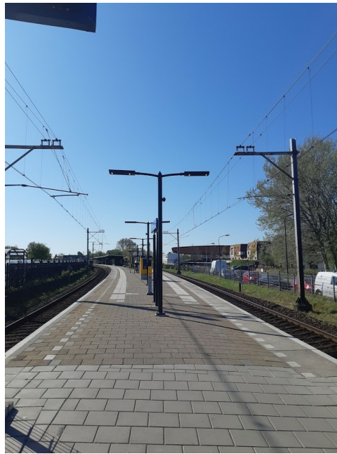
Station Castricum: LED-verlichting met aanwezigheidsdetectie
