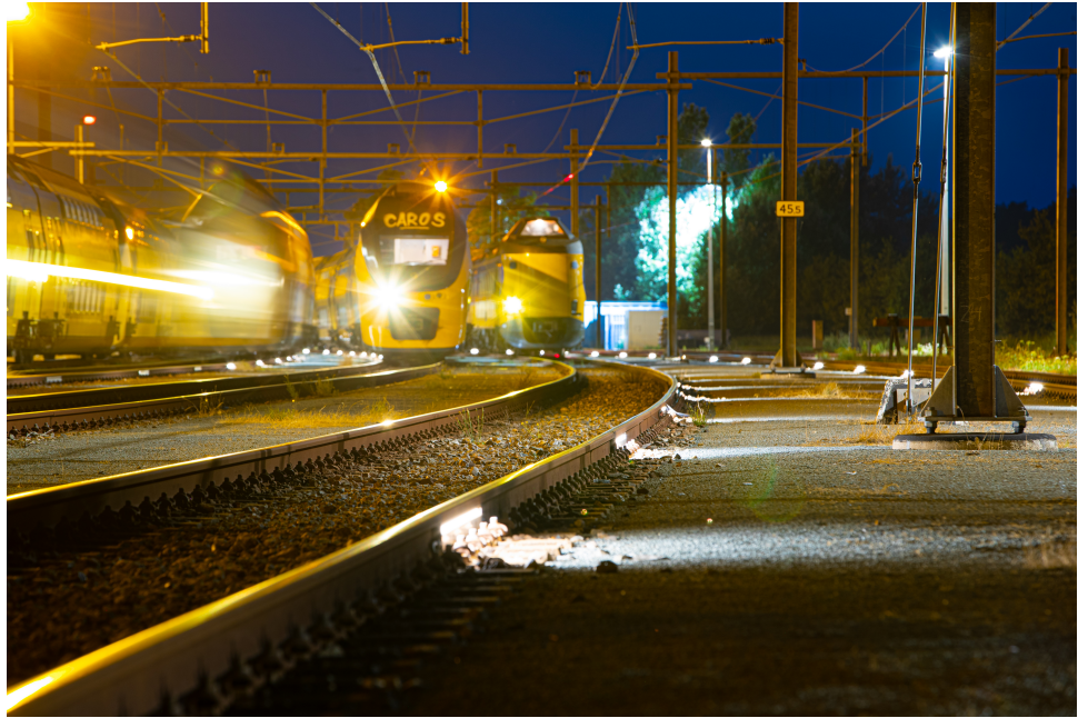
Foto: Raillight - LED verlichting looppad
