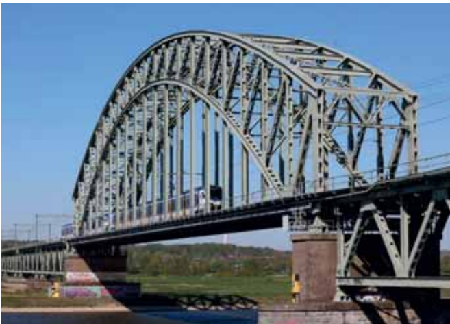
FIGUUR 2: EEN VAN DE TE SANEREN BRUGGEN
